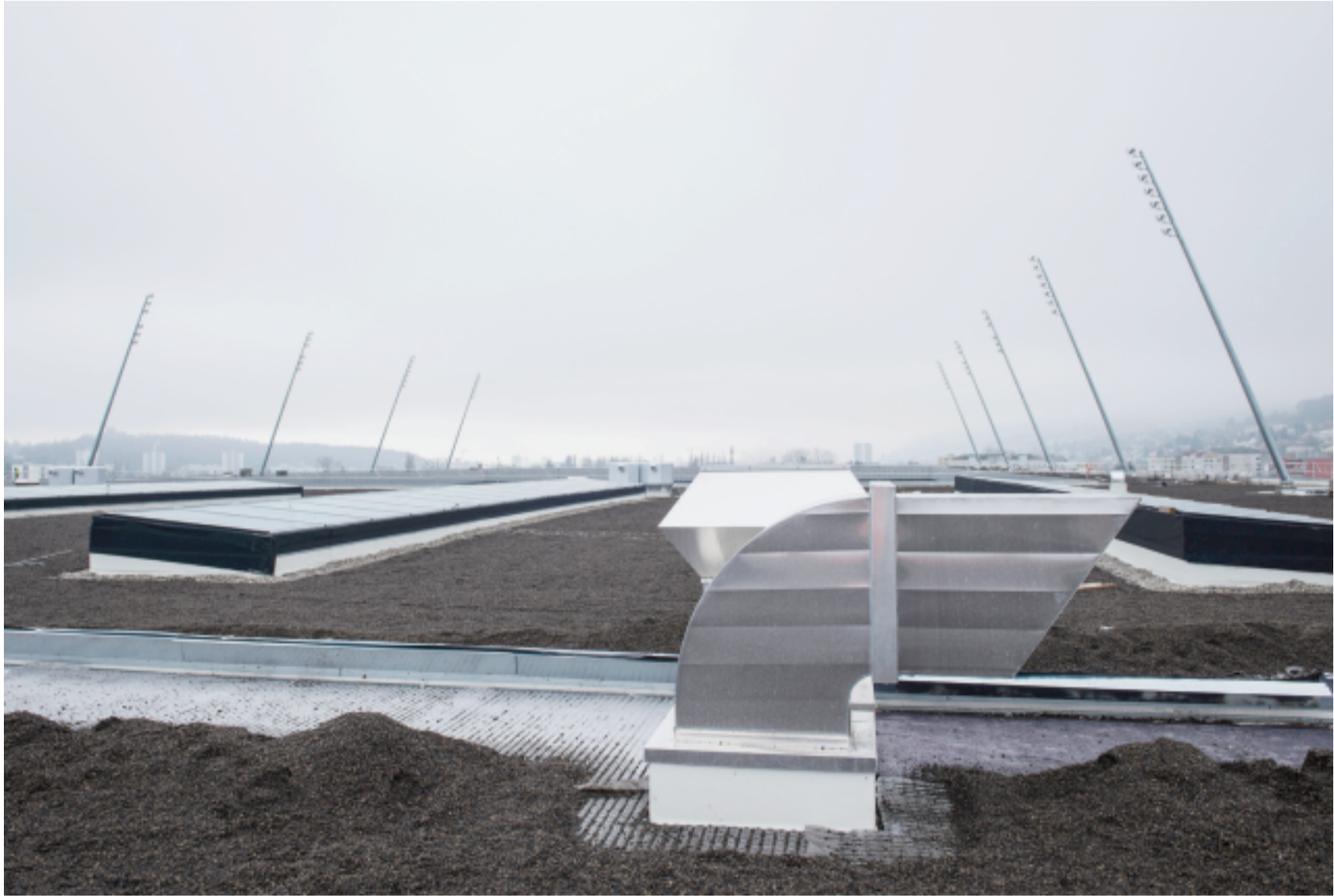
Alles bereit: Auf dem Dach der Stades de Bienne können die Arbeiten für das Solarkraftwerk starten.
